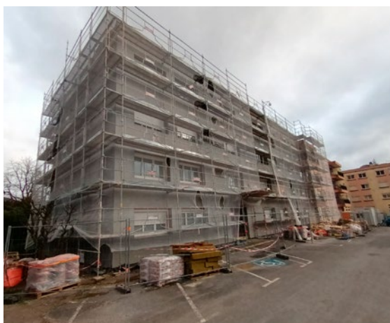
Mise en œuvre du plan avec la rénovation de 47 logements de la Résidence Les Cazes Saint-Affrique
